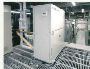
下水熱ヒートポンプ
